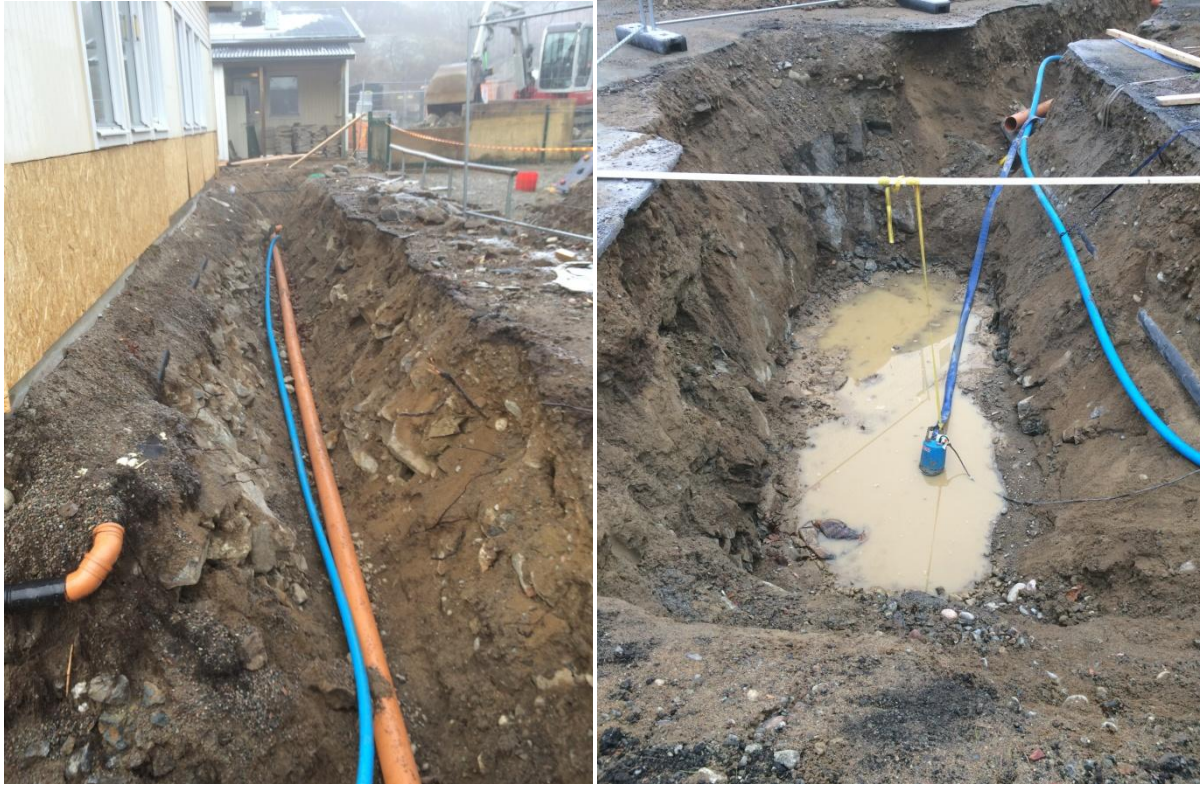
Ny avlopps- och vattenledning är draget till huset och ett större schakt är uppgrävt för den nya fettavskiljaren.
