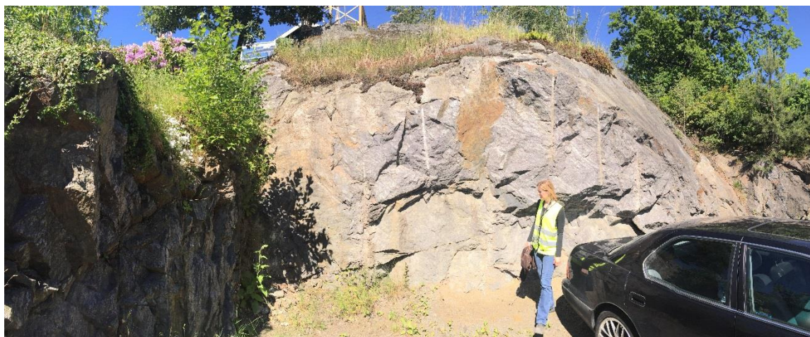
Bild 6: Bergslänter vid privat parkeringsplats vid Skolgatan.
